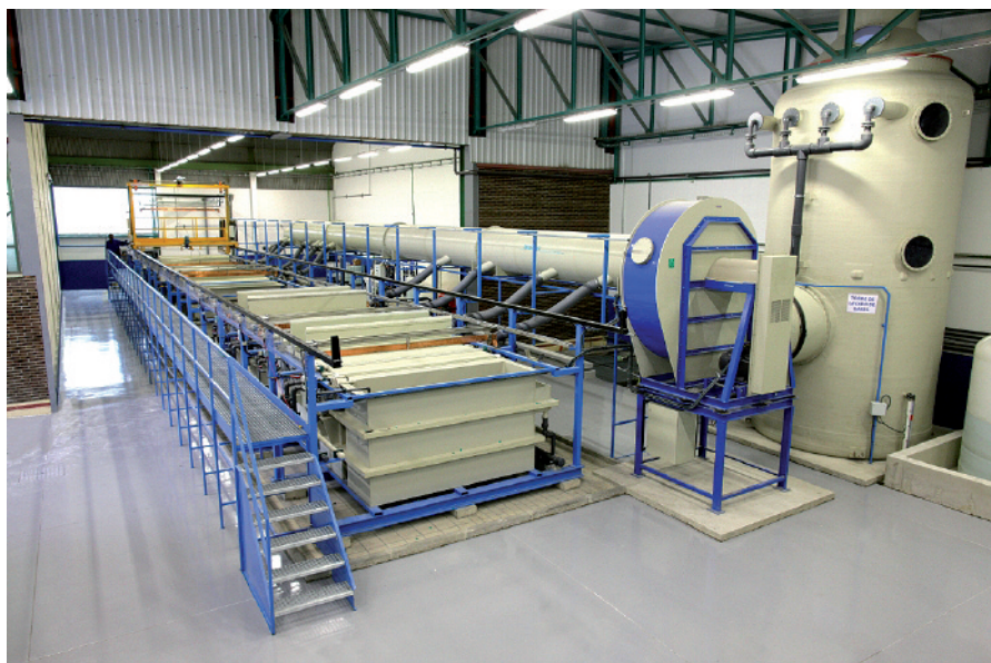
■ La instalación consta de una línea de anodizado TSA que han ido incrementando con la introducción de nuevos baños para el tratamiento del titanio
